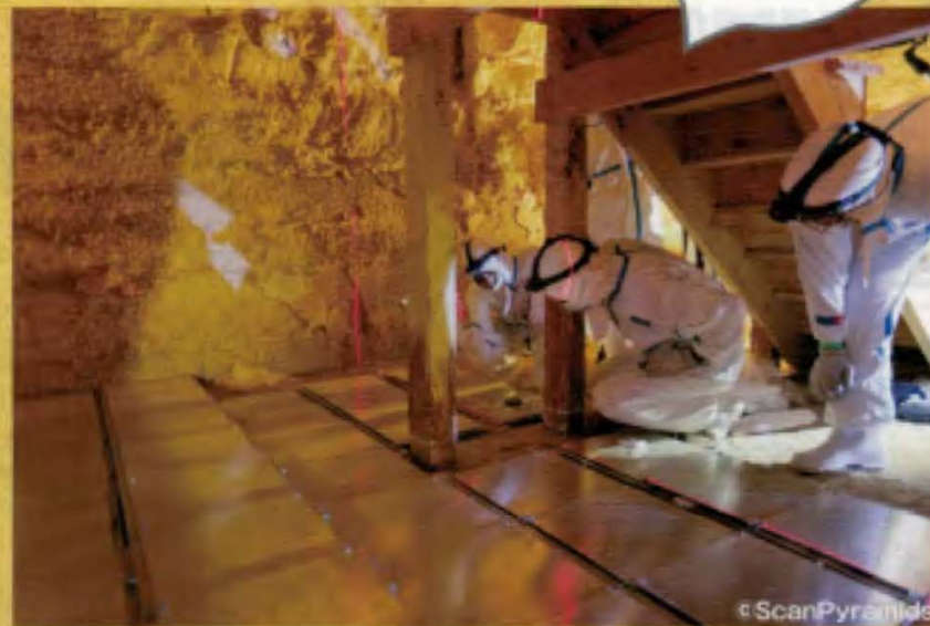
屈折ピラミッドの内部で宇宙線を観測する装置（原子核乾電池）を設置している様子
